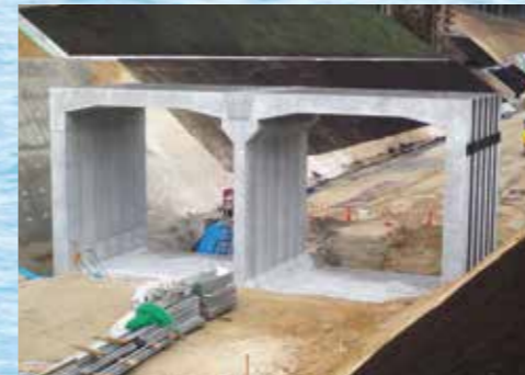
大型ボックス 新鉄台トンネル築造工事 サイズ：7分割BOX (7300+7300)*6700 延長6m 発注者：東北地方整備局 三陸国道事務所 (岩手県)
