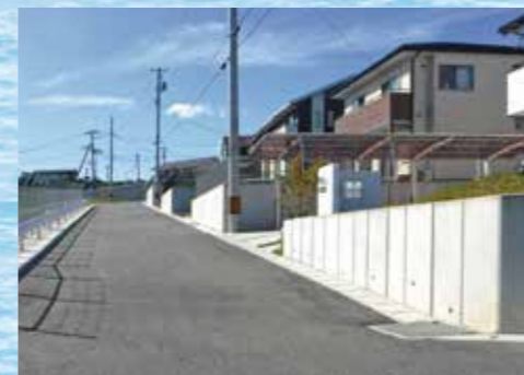
L型擁壁 (高台移転) 気仙沼市防災集団移転 促進事業等造成工事 サイズ：H1000~3000 発注者：気仙沼市役所 (宮城県)
